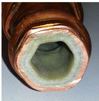
Kupferrohr mit Kalkschicht
