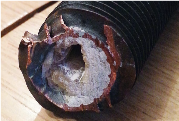
Verkalkter Kupfer-Rippenrohr-Wärmetauscher aus einem Pufferspeicher
