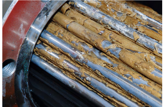
Rohrbündelübertrager mit Kalkablagerungen
